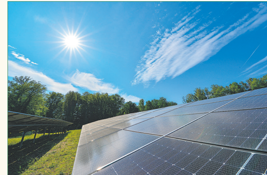
Solarpark: Mit diesen Modulen produzieren die Genossen von „maxwäll“ den Strom für das PPA.
